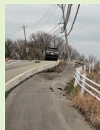
陥没した道路
